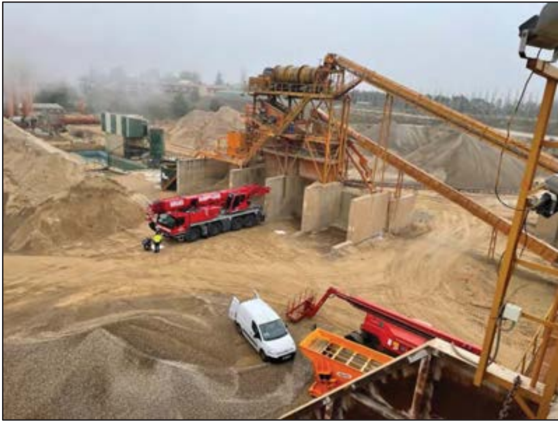
Vista parcial de las instalaciones de tratamiento.
